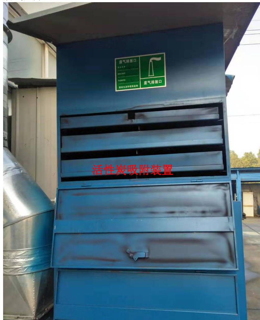
附件 13 环保设施及环保标识牌照片。 废气照片
